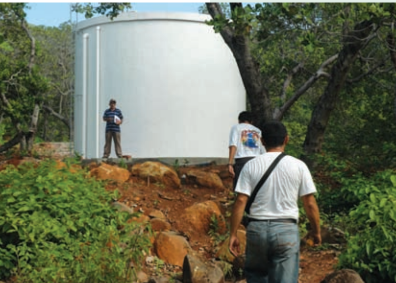
Tanque de almacenamiento de agua.
