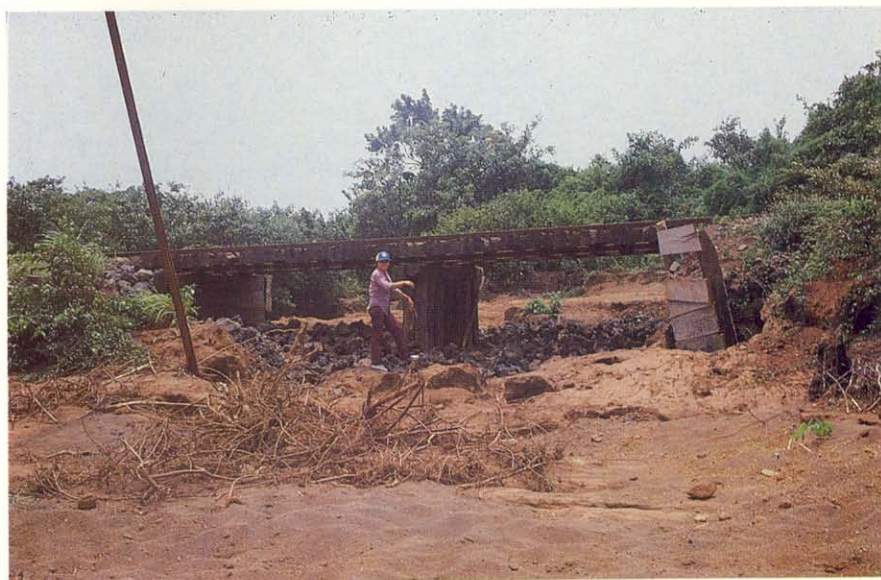
5.—La paralización del ferrocarril por daños de infraestructura, representa la no movilización por este medio de 420 a 1.200 toneladas de carga diaria.
